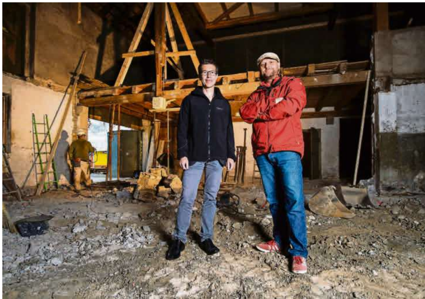
Freuen sich, dass der Umbau der Schlosshügel-Scheune begonnen hat: Housi Suter (rechts), Bereichsleiter Landwirtschaft bei der Stiftung Wagerenhof und Bernhard Maier, Projektleiter.
